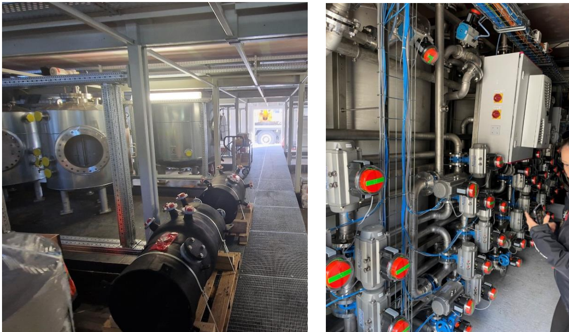
Figure 21 : Réception des cuves d'extraction (à gauche) et montage du système d'automatisation du processus de concentration de la saumure en lithium géothermal (à droite).
