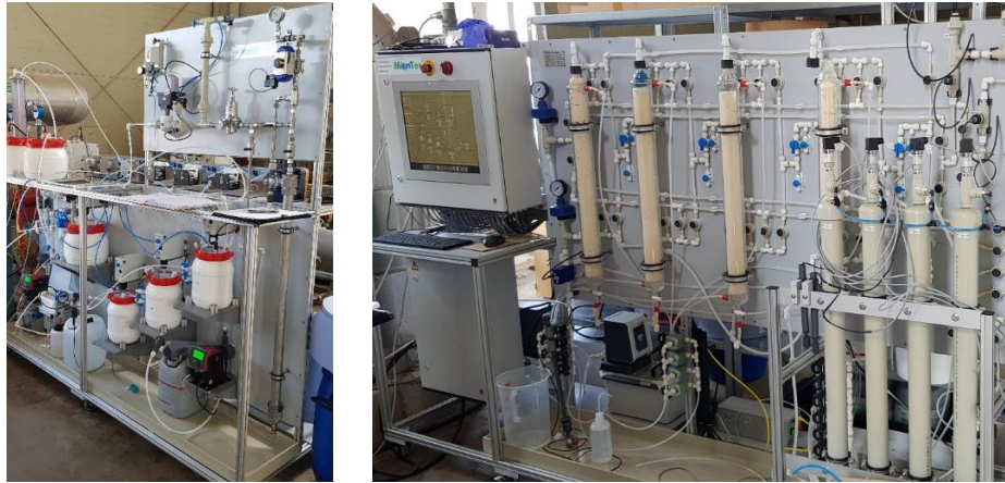
Illustration n° 18 : (à gauche) Installation pilote d'extraction du lithium, unité de prétraitement de la saumure. (à droite) Installation pilote d'extraction du lithium, unité DLE.
