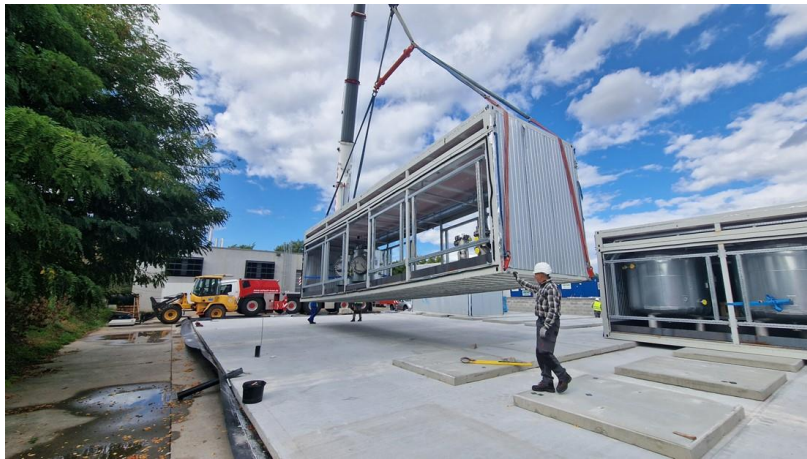
Figure 16 : Mise en place de la dalle béton et des conteneurs qui hébergeront le démonstrateur d'extraction de lithium sur le site de Landau.
